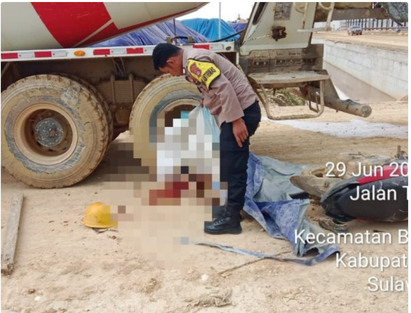
Tampak pekerja TKA tewas terlindas truk 10 roda
